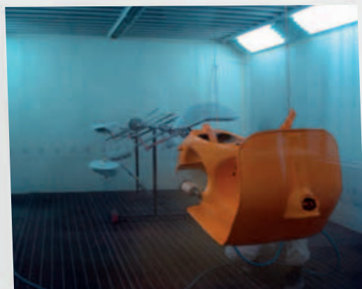
... riscaldamento di cabine di verniciatura
